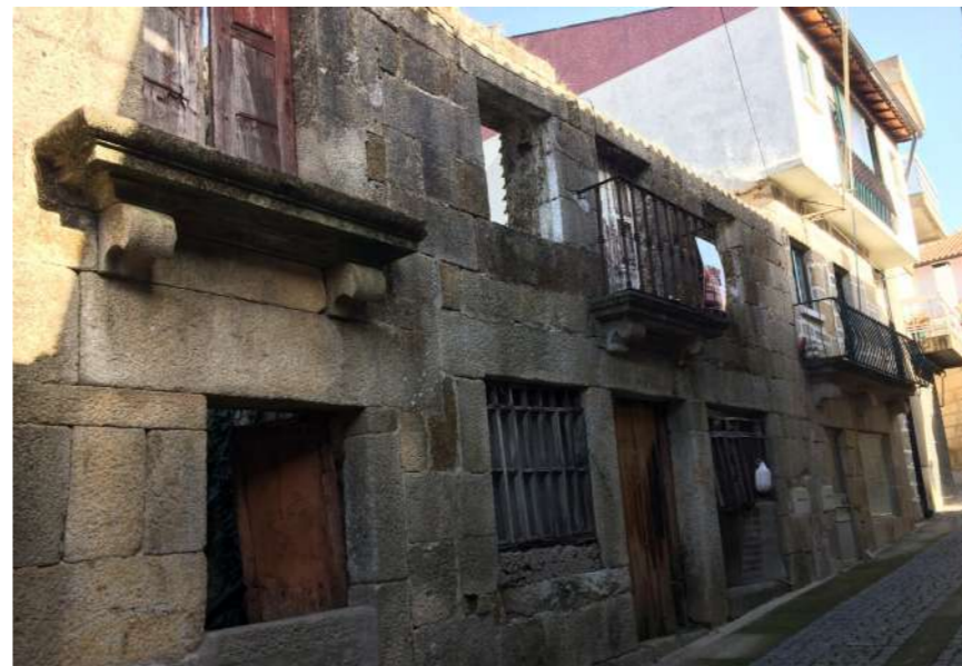
74 | Edifício em ruína
