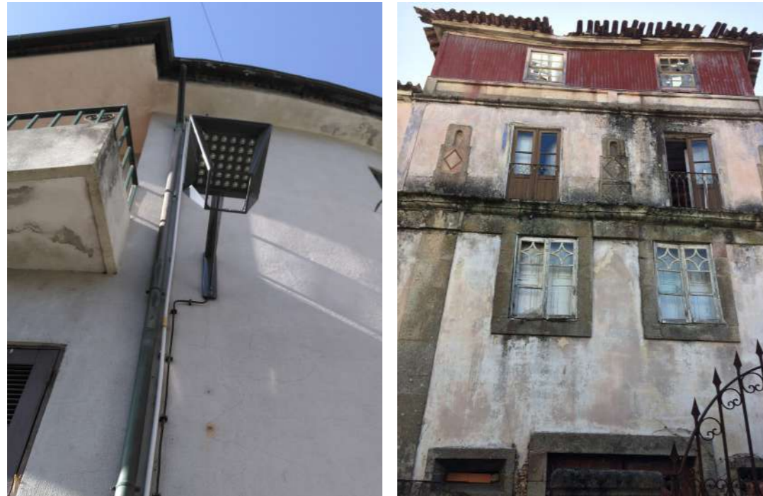
86 | Fachadas com manchas e bolores
