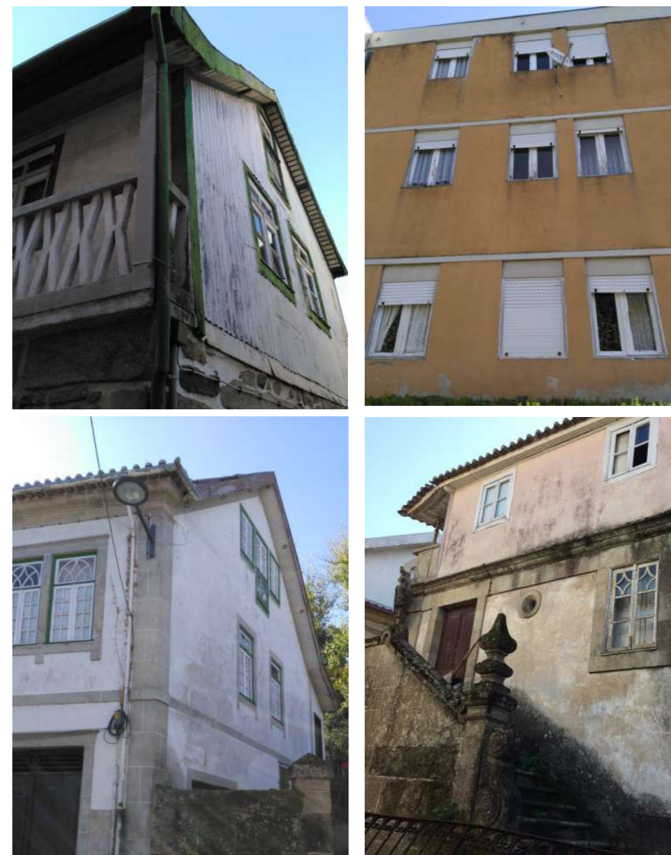
85 | Fachadas com manchas e humidade
