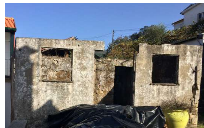
89 | Edifícios em Ruína
